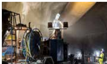
Åtgärda bristerna, annars stoppar vi arbetet, säger Arbetsmiljöverket.
